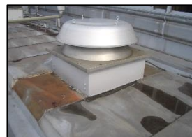
ベンチレーター
