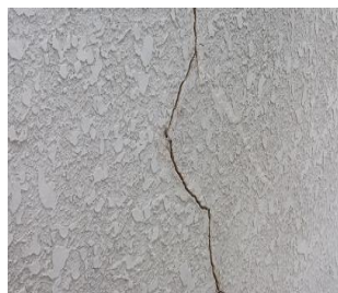
<外壁クラック>
